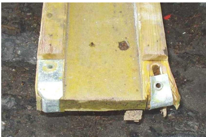
02.27 End cap damaged 金屬頭損壞
