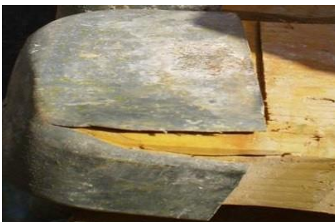
02.28 End cap damaged 金屬頭損壞
